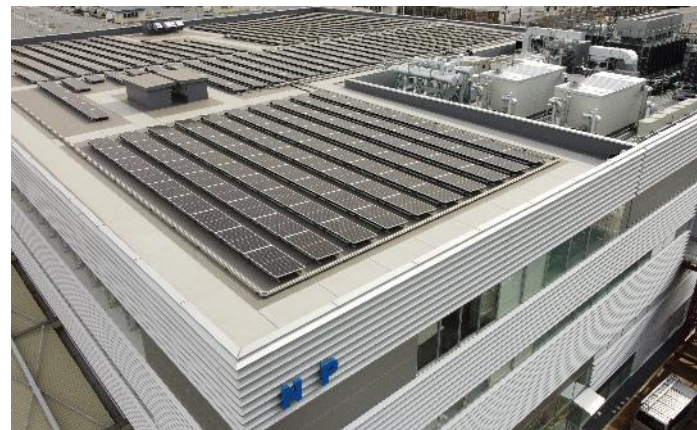
藤沢事業場、太陽光発電装置
