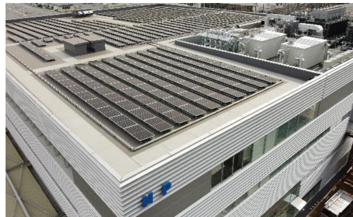
藤沢事業場、太陽光発電装置
